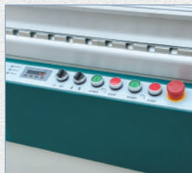
Panel de control Main control panel Panneau de commande
